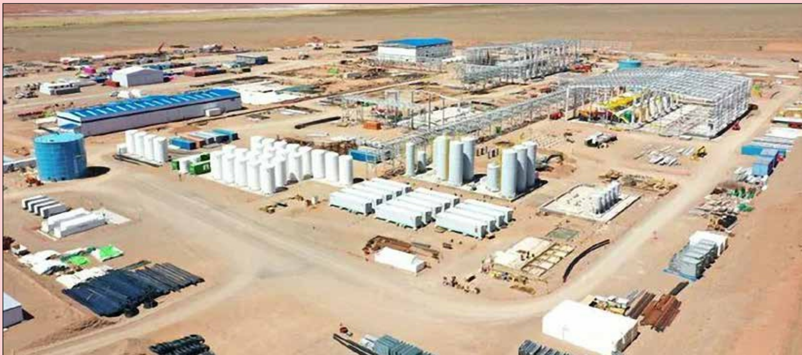
Planta ubicada en el salar Centenario Ratones es la primera mina de producción de litio en Salta.
